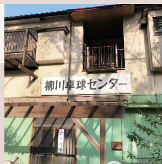
Before 1階入口はガラス扉。外壁塗装も1階と2階の色が違う。
